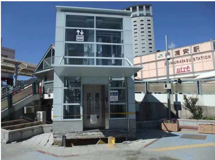
1 JR 新浦安駅前のエレベータ施設の被害 歩道側の地盤の陥没でエレベータ施設が浮き上がった状態に。(黄色は 15cm の野帳) 2011.3.17
