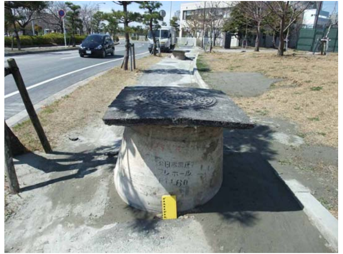
4 浦安市明海1丁目歩道に浮上した汚水マス被害 歩道の下に埋設された下水道管が損傷、液状化の際に 浮力でマンホールが道路から飛び出した。2011.3.17
