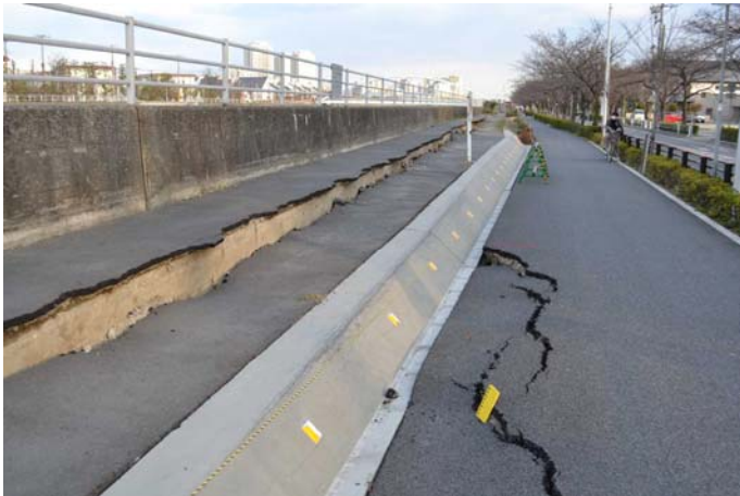
5 境川の護岸脇の歩道の被害 今川1丁目境川右岸歩道のアスファルトは大きく亀裂 が入り、歩道は崩れ沈下した。2011.3.27
